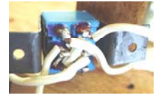
Figura 15. Llave inversora cableada.
